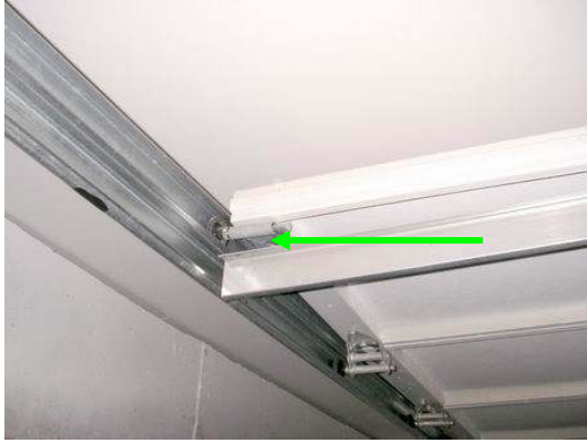
loose garage door bracket
